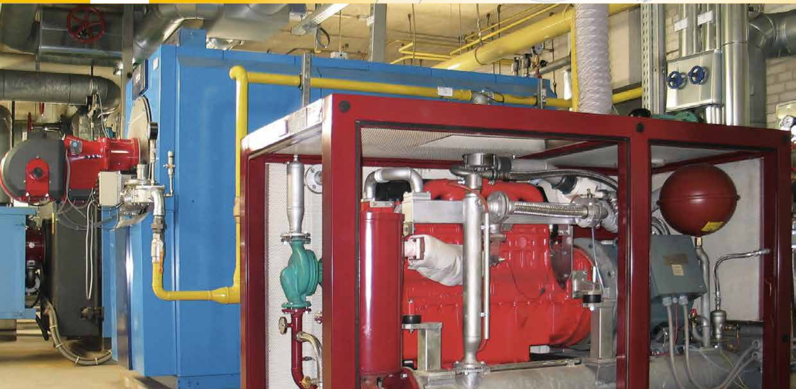
Eingebautes Blockheizkraftwerk im Keller der Europaschule Köln
