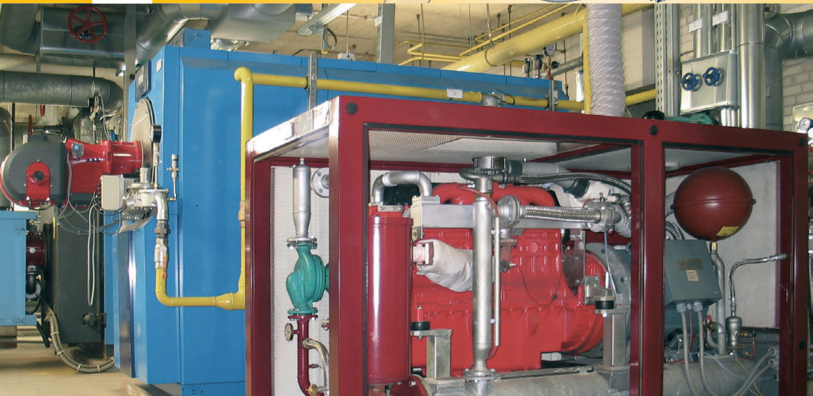
Centrale de cogénération installée dans le sous-sol de l'Europaschule de Cologne
