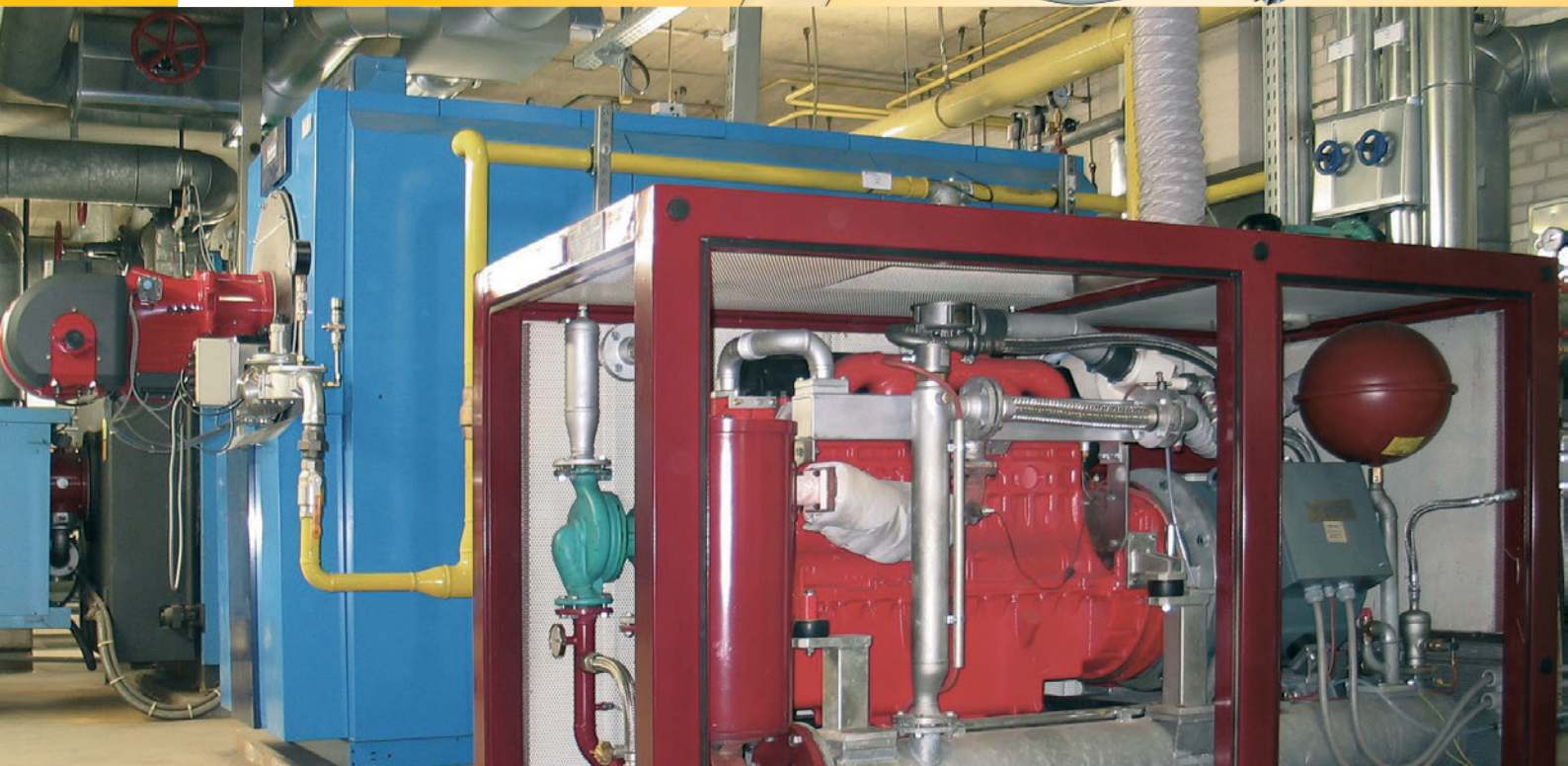
Planta de cogeneración instalada en el sótano de la Europaschule de Colonia
