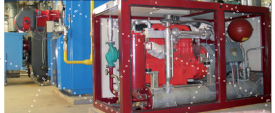
Heizzentrale mit BHKW
